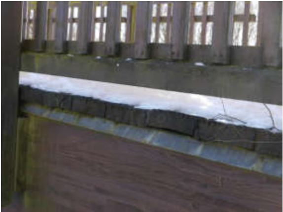
Starke Schäden am Bohlenbelag
